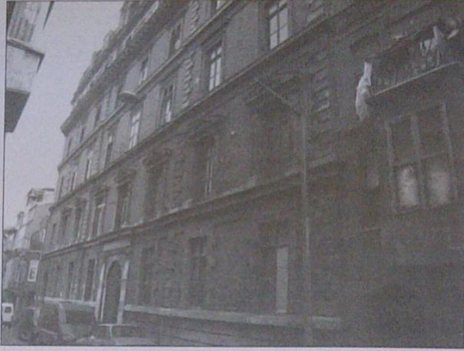
Foto 1 İstanbul, Beyoğlu Anarad Hıgutyun Ermeni Katolik Rahibeleri Mektebi Binası, kuzey cephe, atmosferik kirlenme
